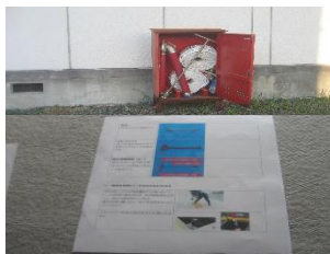
【消火栓 操法訓練】
